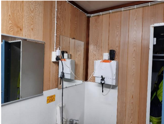
Työmaakoppi, mittariparit mittausmassa
